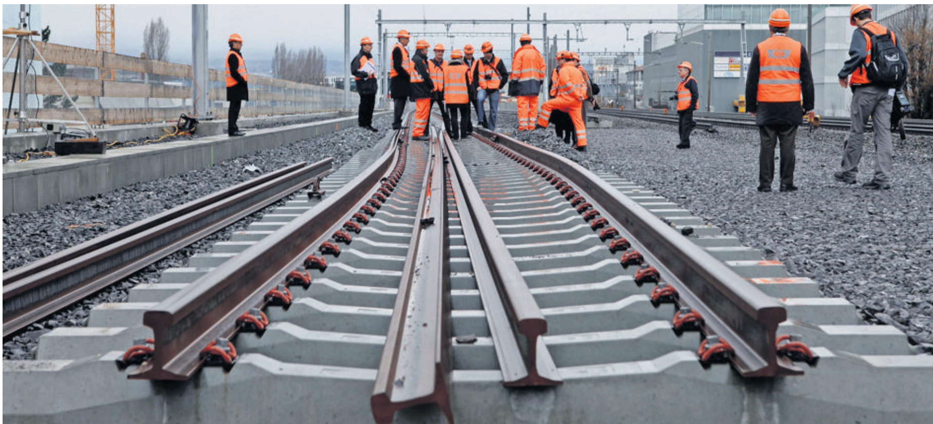
La mise en service de la voie sud de la gare de Prilly-Malley n'était qu'un amuse-bouche en regard des grands travaux qui se préparent. Mais le personnel qualifié pour les réaliser fait cruellement défaut, forçant les entreprises à se tourner vers l'étranger. FRANCESCA PALAZZI
