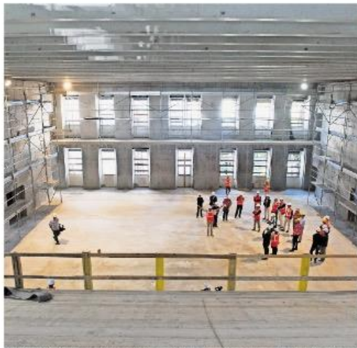
IMPONENTE Sette anni di lavoro per la costruzione grezza, visitando il palazzo (qui la sala cinema da 500 posti) si respira già un'aria da grande opera. (Foto Crinari)
