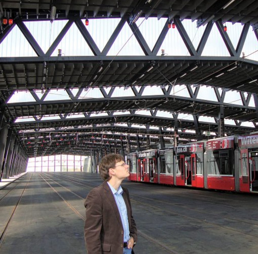
Das Tramdepot beeindruckt nicht nur durch seine Grösse, sondern auch durch die spezielle Bauweise.
