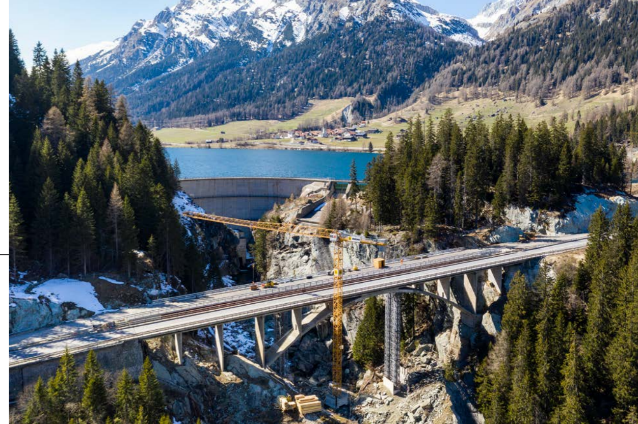
Le pont de Crestawald sur la route nationale N13 dans le Rheinwald près de Sufers lors de sa réfection et de son élargissement (2017-2023)
