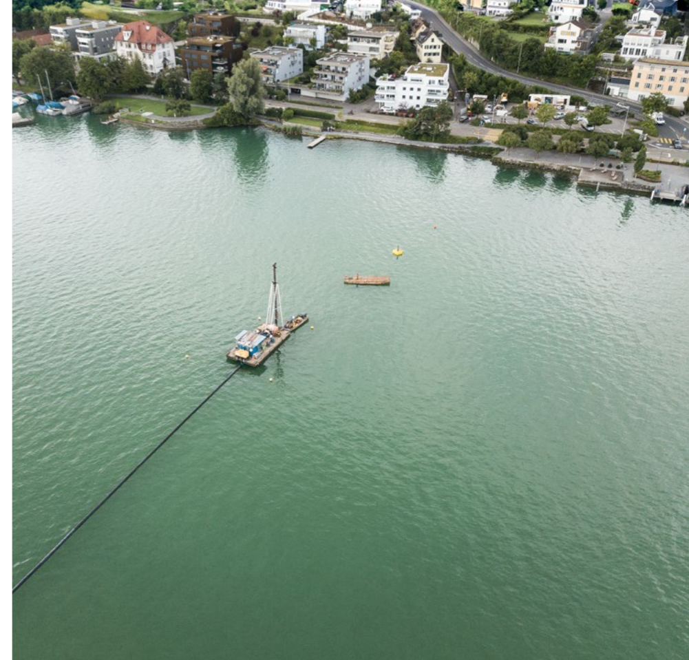
Le lac de Zurich, source de production d'énergie thermique en profondeur
